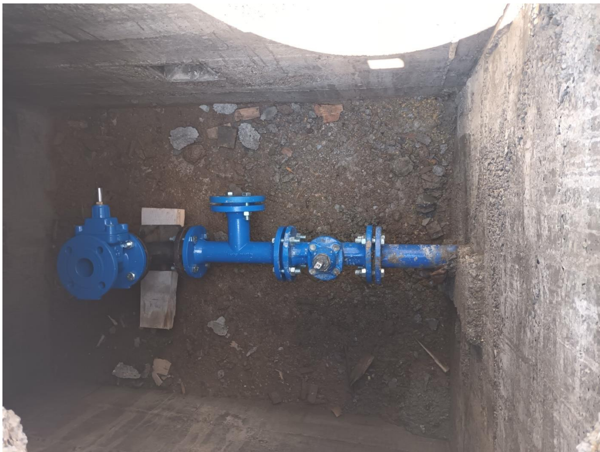
Tipska završna šahta za izradu priključnih krakova i ugradnje vazdušnog ventila vodosnabdevanja dela sela Mlekominci
