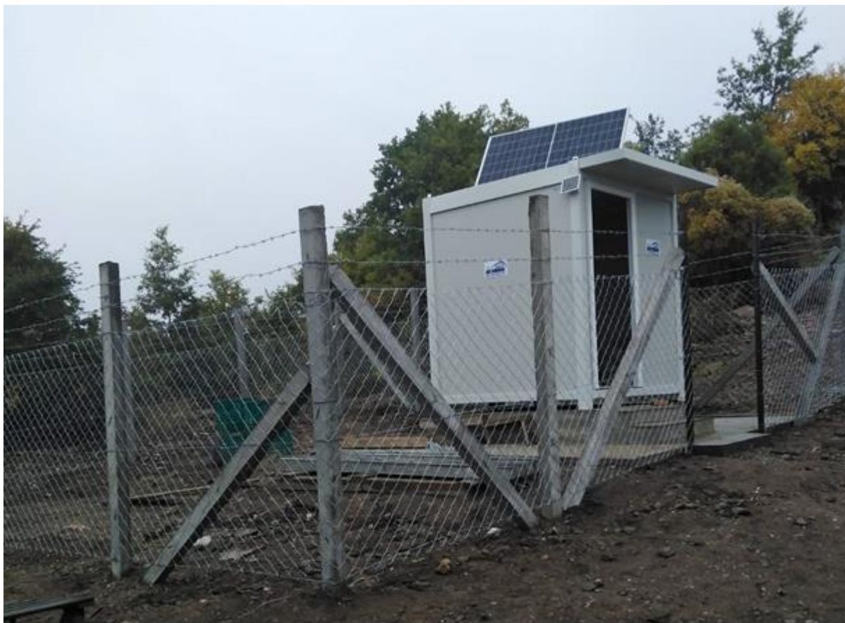
Postrojenje za Hlorisanje vode na sistemu Roda voda
