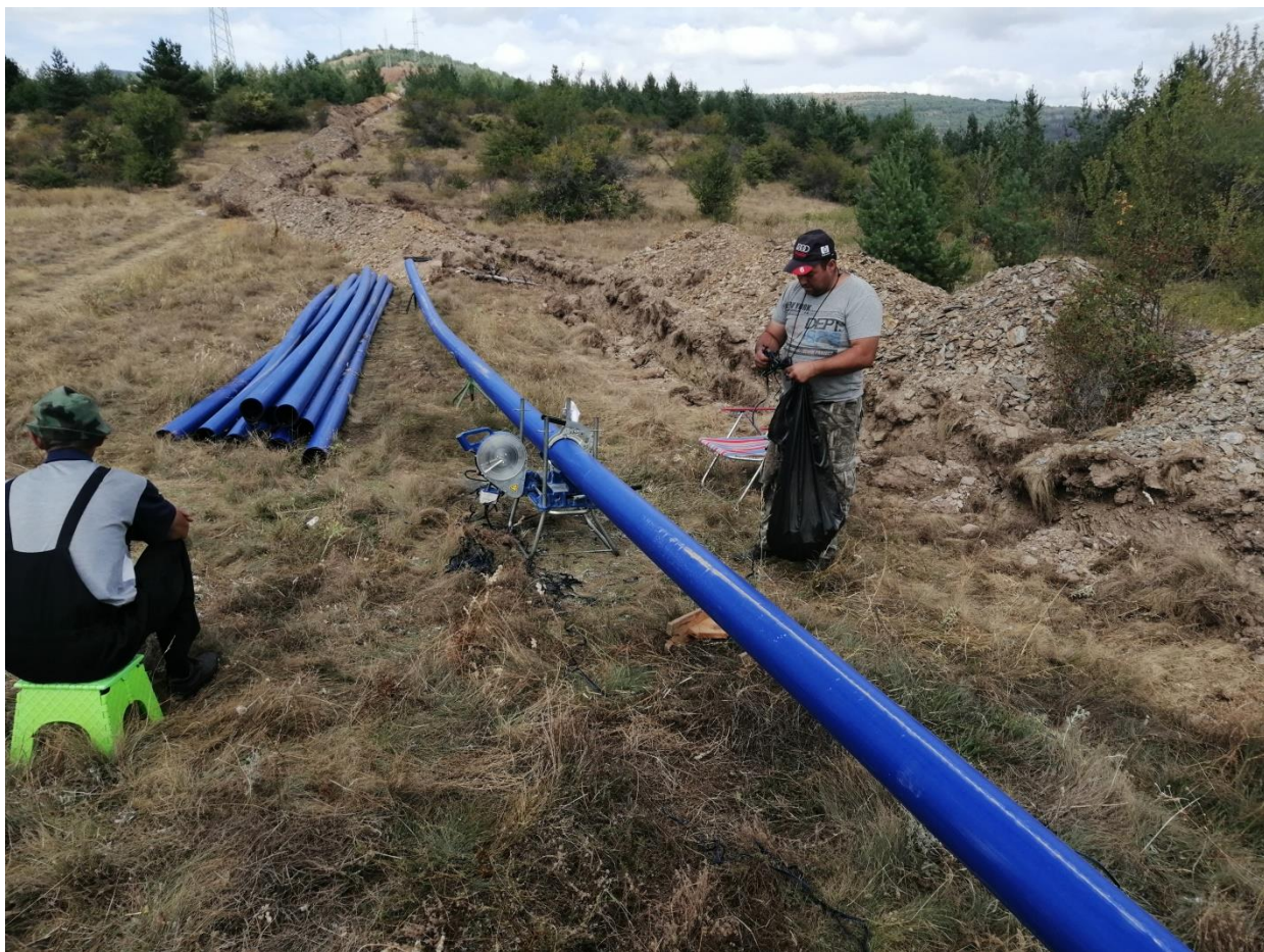
Cevovod „Roda“ voda
