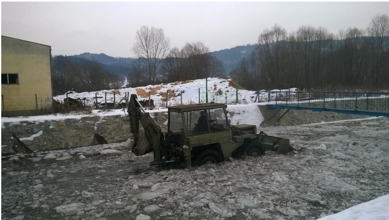
Pripremni radovi na sanaciji havarije na vodovodnoj liniji u zimskom periodu u koritu reke Dragovišnice
