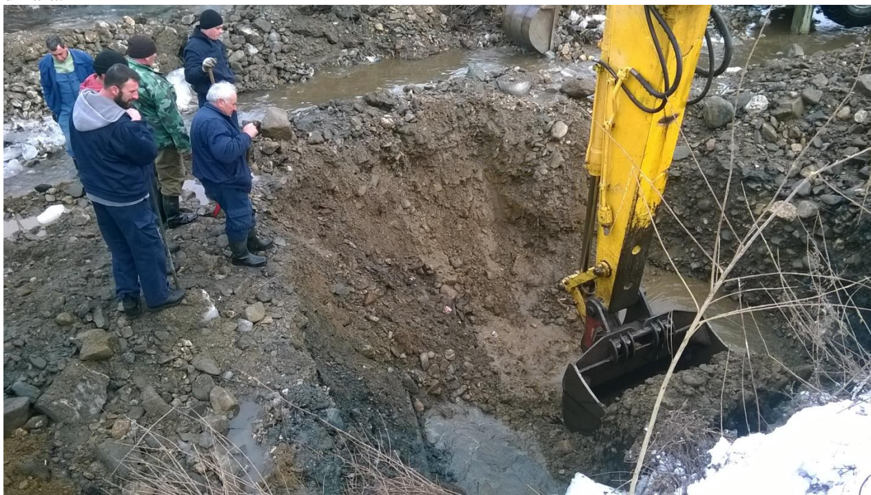
Lociranje mesta havarije i sanacija havarije na vodovodnoj liniji za s Rajčilovci
